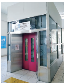
エレベーター(野方駅)
