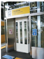
エレベーター(江古田駅)
